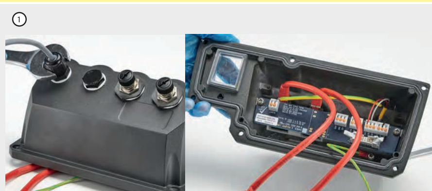
Figure 10 - Blindage à la terre des câbles de commande sur module NEMA EtherNet/IP™.
