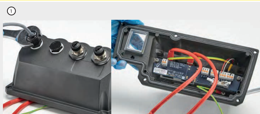
Figur 10 - Jordskärmning av styrkablar påPROFINET® NEMA-modul
