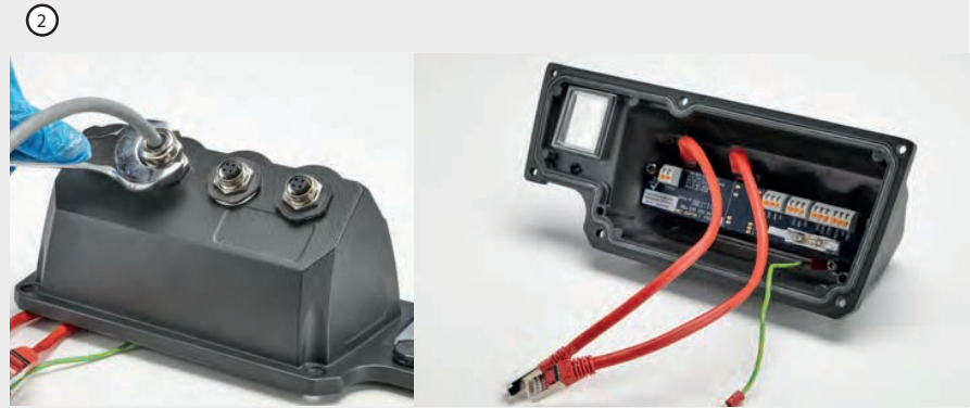
Figure 10 - Blindage à la terre des câbles de commande sur module NEMA EtherNet/IP™.
